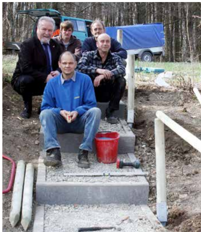
Ein lang gehegter Wunsch der Extertaler Wanderfreunde ging jetzt in Erfüllung: Der marode Aufstieg zur Hohe Asch wurde jetzt durch die Mitarbeiter der EUWATEC saniert.
